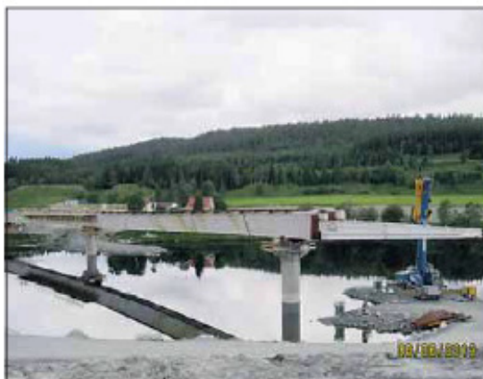
HALVFERDIG: Nes bru står halvferdig etter konkursen. FOTO: STATENS VEGVESEN.
